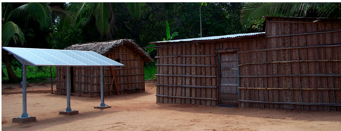
Eletrificação de residência em Matalalane – FUNAE
